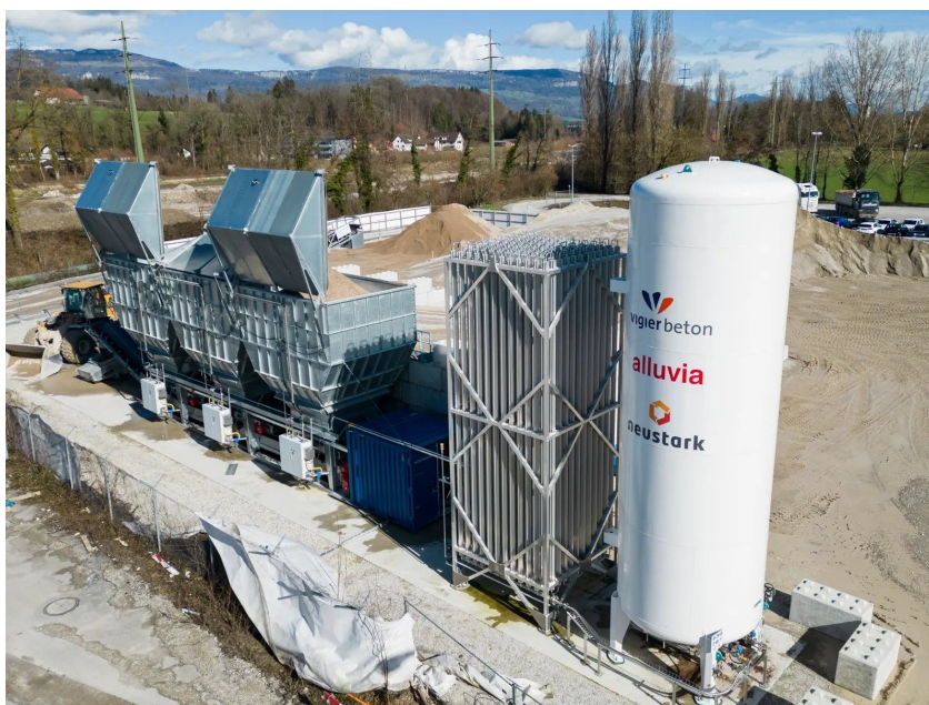
Installation de carbonatation pour le stockage du CO 2 à Biberist (CH)
