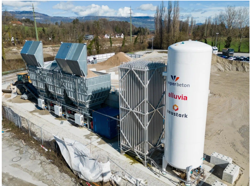
Carbonatisierungsanlage zur CO 2 -Speicherung in Biberist (CH)
